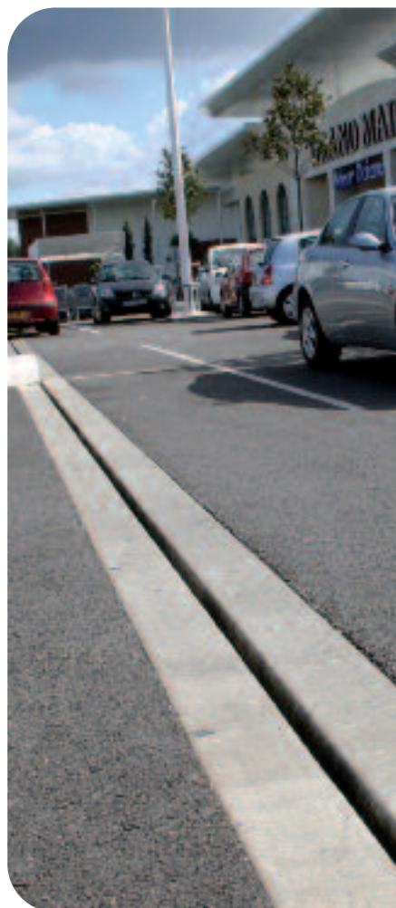
Récupération des eaux de pluies sur le parking du centre commercial Le Grand Mail à Saint-Paul-lès-Dax
